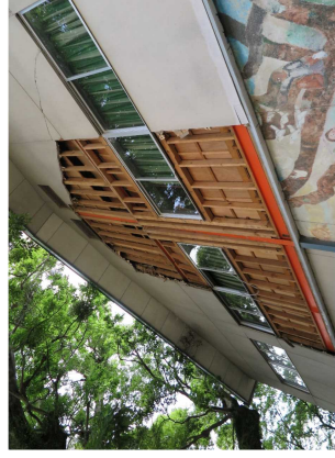
<最上階ホール天井の脱落（校舎）>
