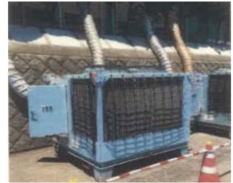
エアコン(室外機)
