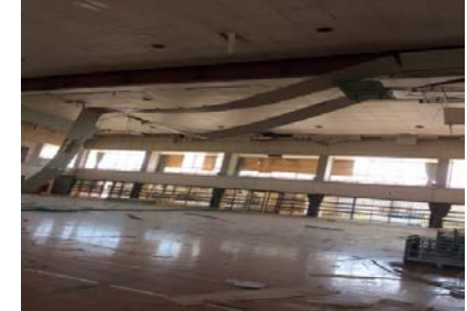
天井の一部が落下した体育館
