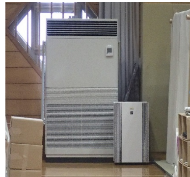
エアコン(室内機)
