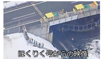
仮設緊急出入口での訓練状況
