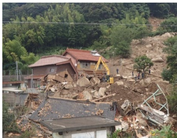
土石流被害現場視察 【佐賀県唐津市浜玉】
