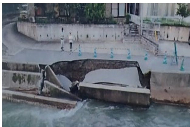
道路崩落現場視察 【福岡県久留米市国分町】
