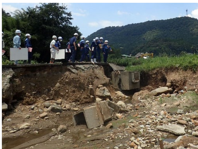
被災現場確認 【伊佐市大口山野】
