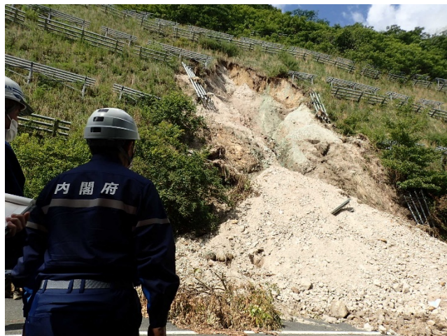
被災現場確認 【飯南町下来島地区】
