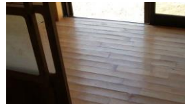
床材層間剥離等
