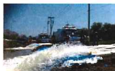
排水ポンプ車
