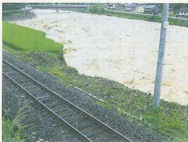
《参考・岐阜県提供》宮川 護岸崩壊の様子 【飛騨市宮川町桑野地区】
