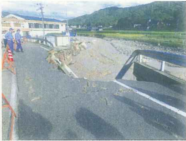
前山川の護岸損壊により被害を受けた県道沼市島線の様子【兵庫県丹波市市島町徳尾地区】
