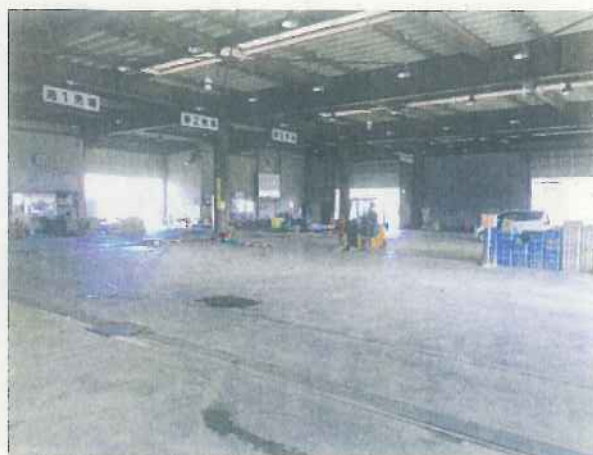
浸水被害を受けた地方卸売市場の様子 【京都府福知山市問屋町地区】
