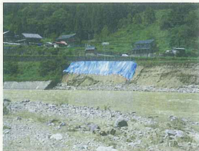
崩壊した宮川の護岸の様子 【飛騨市宮川町桑野地区】
