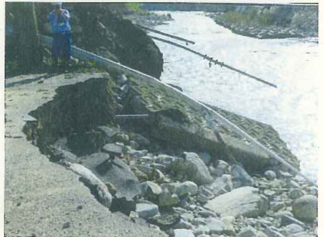
崩壊した川上川の護岸の様子 【高山市清見町福寄】
