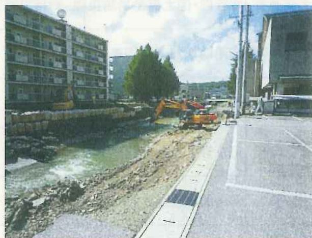
被害を受けた苔川の護岸の様子 【高山市西之一色町】
