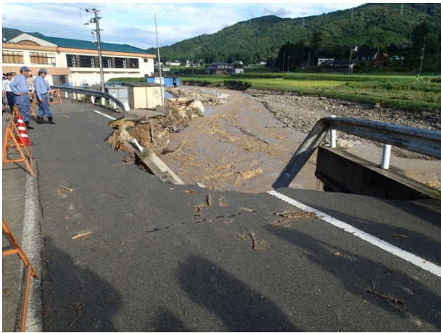
前山川の護岸損壊により被害を受けた県道沼市島線の様子【兵庫県丹波市市島町徳尾地区】
