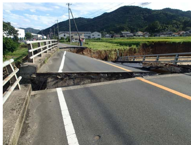
被害を受けた橋梁の様子 【兵庫県丹波市市島町上竹田地区】
