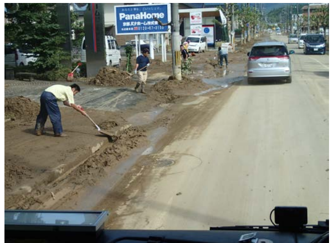
泥土に覆われた道路の後片付けの様子【京都府福知山市内】
