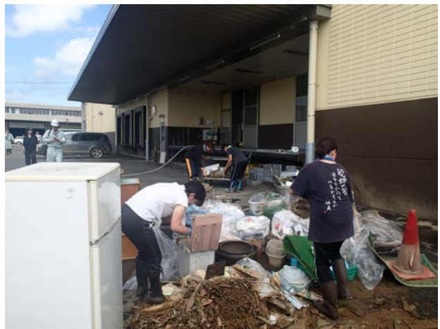
浸水被害を受けた学校給食センターの 復旧作業の様子【京都府福知山市問屋町地区】
