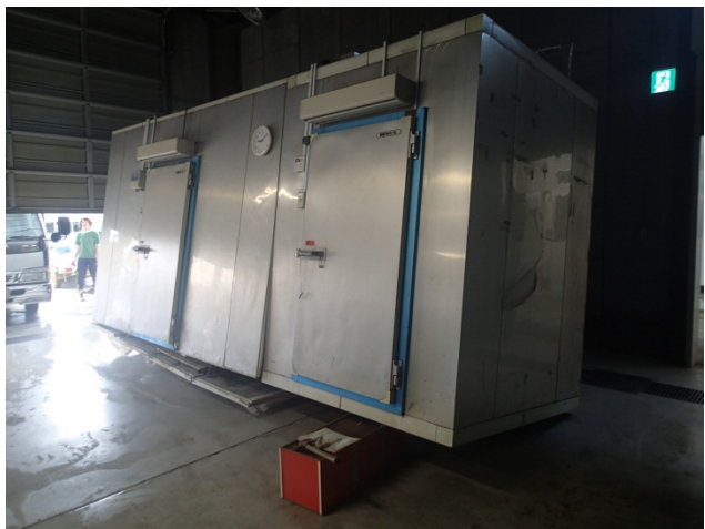
浸水被害を受けた地方卸売市場の冷蔵庫 【京都府福知山市問屋町地区】
