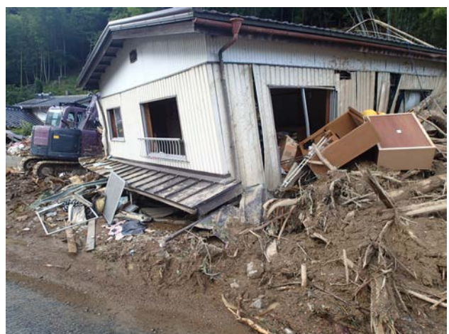
土砂災害の被害を受けた住宅の様子 【兵庫県丹波市市島町徳尾地区】
