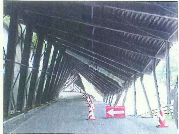
被害を受けた国道341号線のスノーシェッド (雪崩よけ)【仙北市田沢湖玉川地区】
