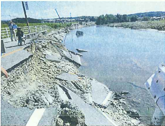
国道422号の被害の様子【伊賀市神戸地区 カンベ 】
