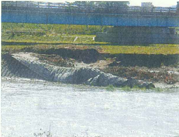
被害を受けた馬淵川の護岸 【三戸郡南部町門前地区】
