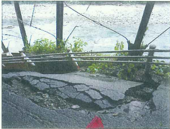
玉川の増水により洗掘被害を受けた国道 341号線【仙北市田沢湖玉川地区】
