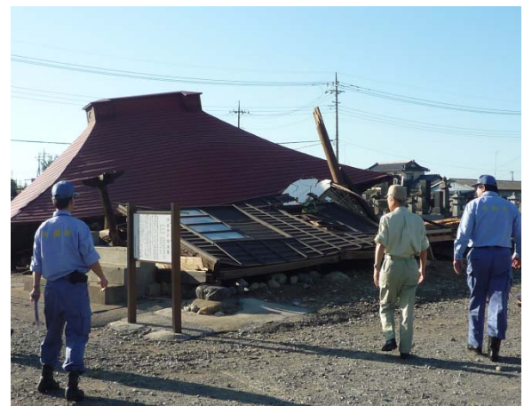
浄安寺の被害の様子① 【熊谷市江南地区】
