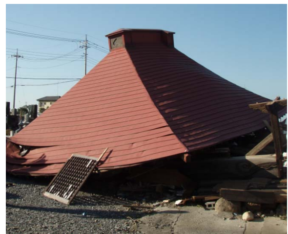
浄安寺の被害の様子② 【熊谷市江南地区】
