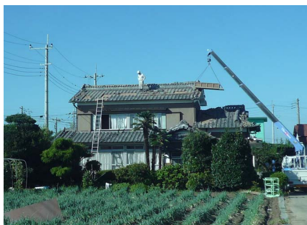
住宅街の被害の様子① 【熊谷市妻沼地区】
