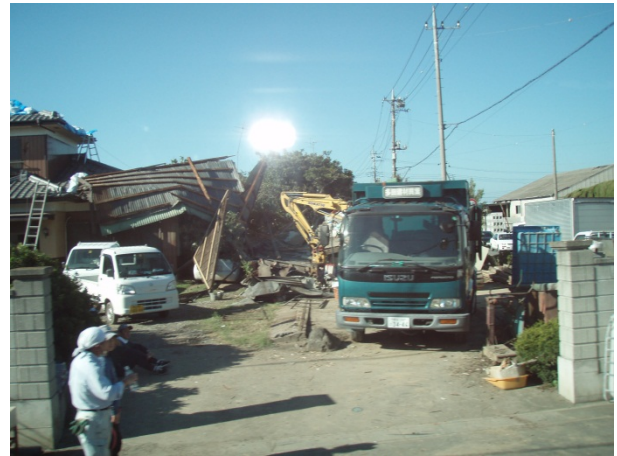
住宅街の被害の様子④ 【熊谷市妻沼地区】
