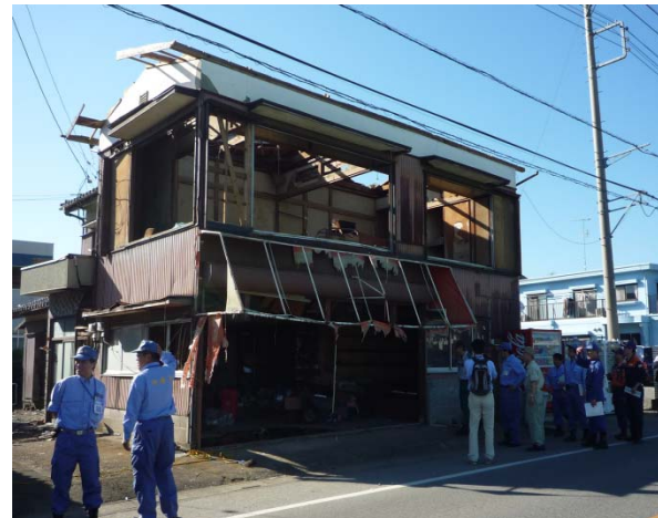
住宅街の被害の様子③ 【熊谷市妻沼地区】
