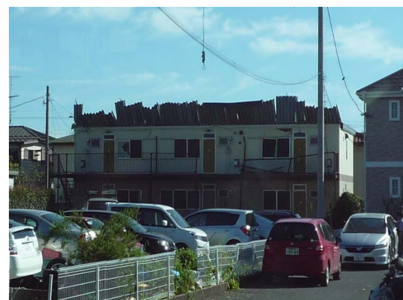
住宅街の被害の様子② 【熊谷市妻沼地区】
