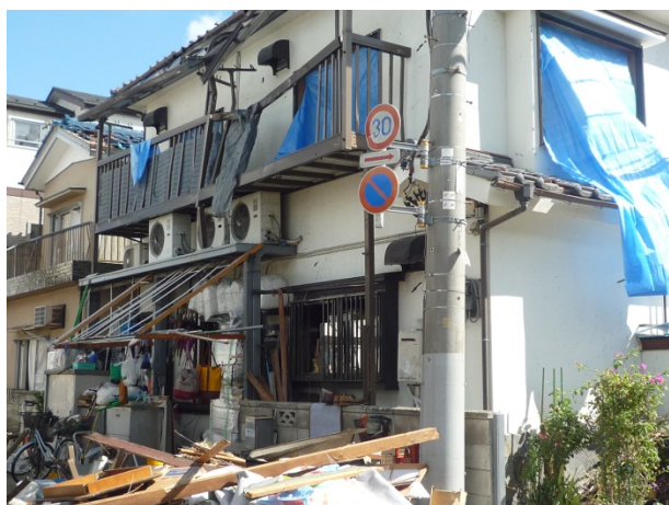
住宅街の被害の様子③ 【埼玉県越谷市大袋地区】
