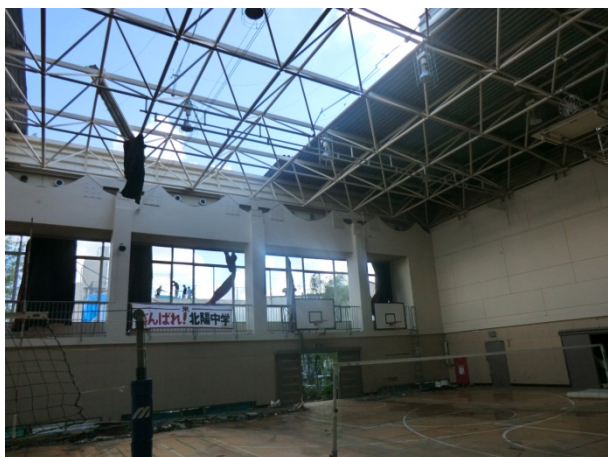
中学校体育館の被害の様子 【埼玉県越谷市大松地区】
