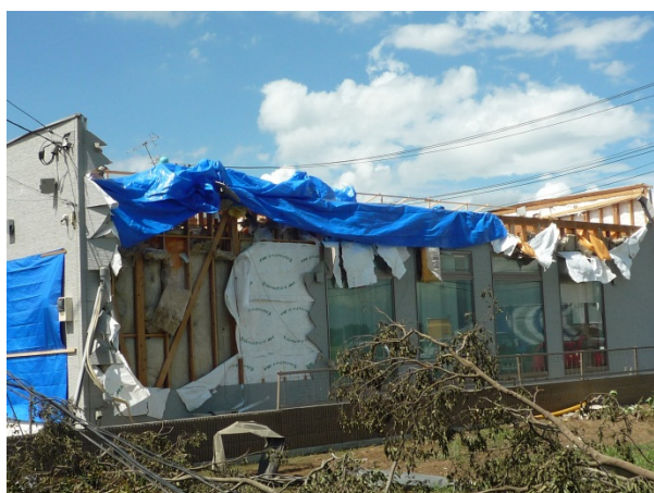
住宅街の被害の様子④ まつぶしまちおおかわど 【埼玉県松伏町大川戸地区】
