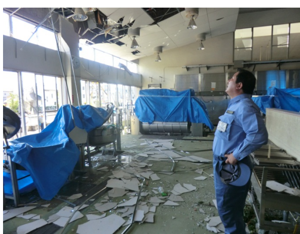
給食センターの被害状況を調査する 亀岡政務官【埼玉県越谷市大杉地区】
