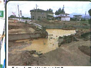
【矢巾町岩崎川橋】 河川の氾濫による被害状況
