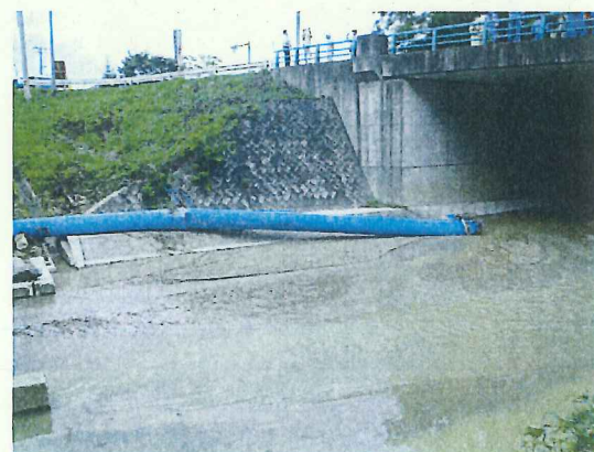
損壊した水管橋【岩手県矢巾町】
