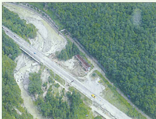
国道46号線の路面崩落を調査【岩手県雫石町】
