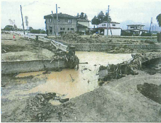
河川の氾濫による岩崎川橋の被害状況【岩手県 矢巾町】
