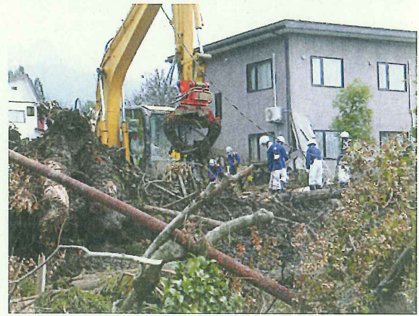
土石流による被害の様子③【同】
