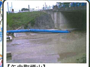
【矢巾町煙山】 水管橋の損壊
