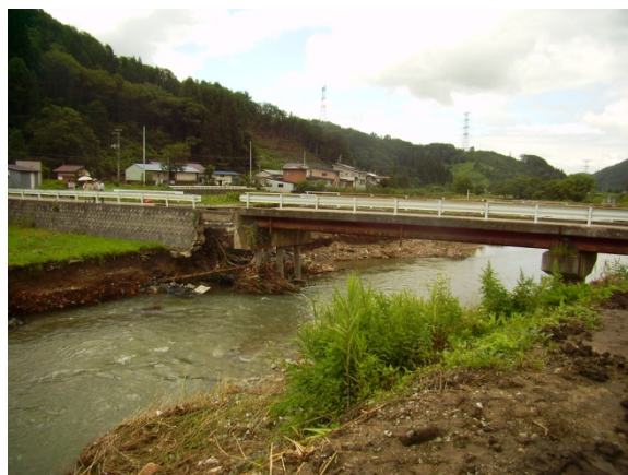
吉野川護岸欠壊の状況 【南陽市金山地区】
