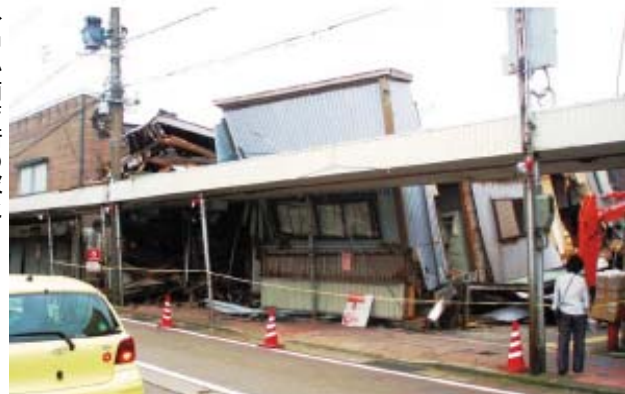
→中心商店街の被災 (柏崎市、新潟県中越沖地震) 写真出典：新潟県中越沖地震記録誌
