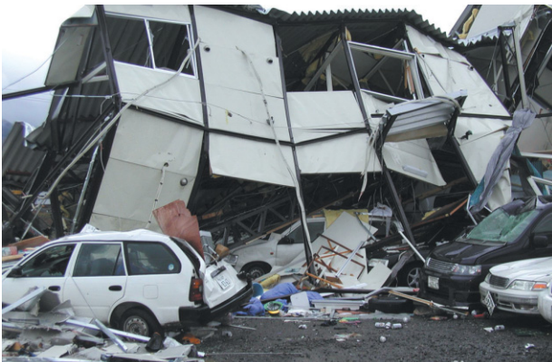
■被災した新さろまトンネル工事事務所および宿舍
