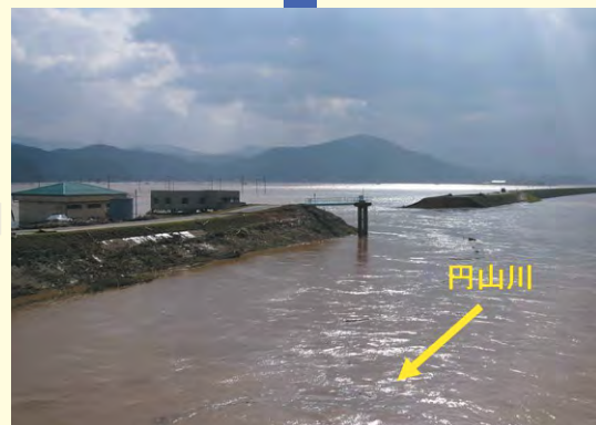
■円山川立野の破堤箇所(平成16年10月) (写真右側の矢印は円山川の流れの方向)
